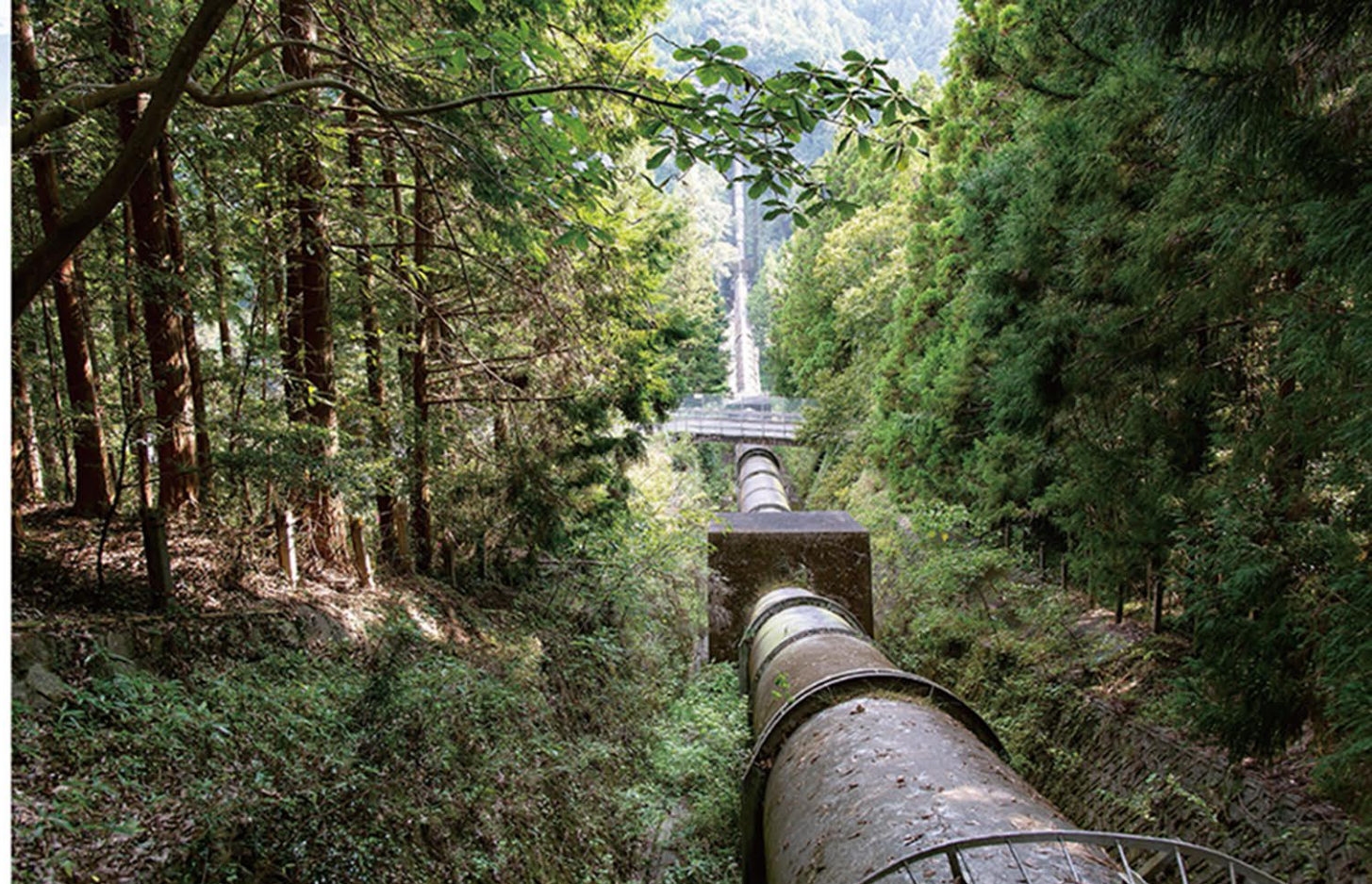
▲山の斜面に沿って阿多古川対岸の山まで続く「導水幹線1号サイホン」
